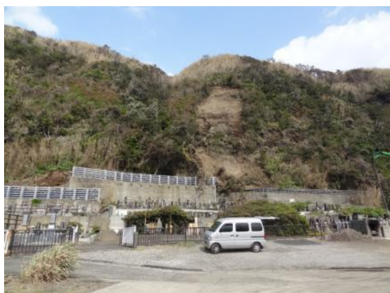
写真 ごく小規模な崩落崖
